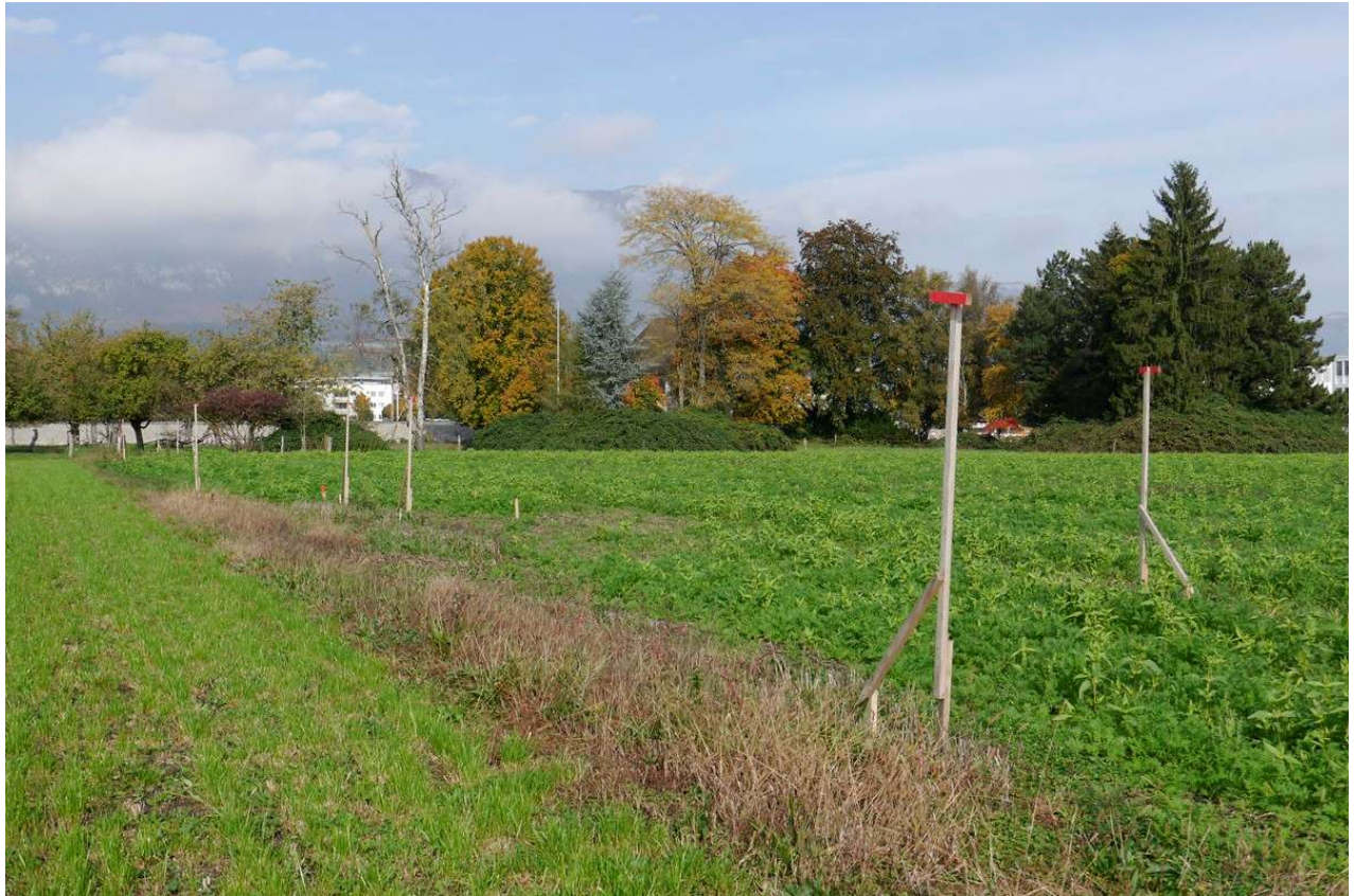
Blick von Süden auf das Baufeld 3 mit den Profilen für die 2. Etappe der Vorbelastung Erschliessungsstrasse
